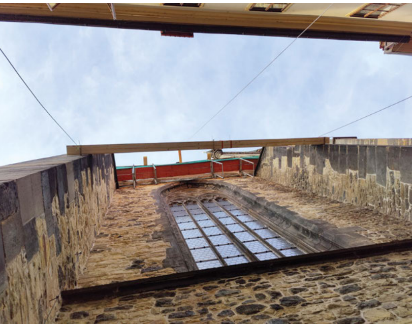
Práce na Chrámu Matky boží před Týnem Work on the Temple of the Church of Our Lady in front of Týn.
